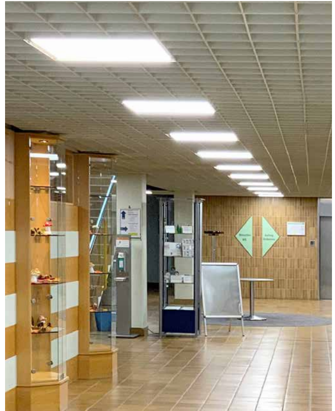
Kreiskrankenhaus Bergstraße GmbH | Heppenheim Eingesetzte Produkte | Deckenrasterleuchten mit Spezialbefestigung [Foyerbeleuchtung] Projektleitung | Jürgen Bortscheller Technische Leitung | Dipl. Ing. [FH] Frank Werz
